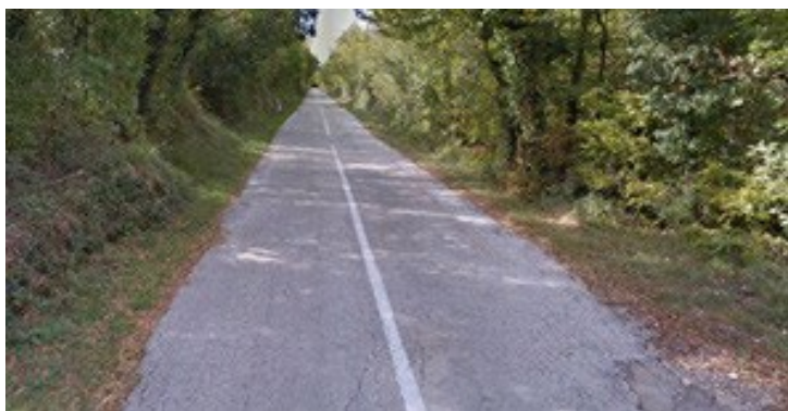
Výmoly a poškození povrchu kvůli prorůstajícím kořenům na trase EuroVelo 8, Chorvatsko [12]
